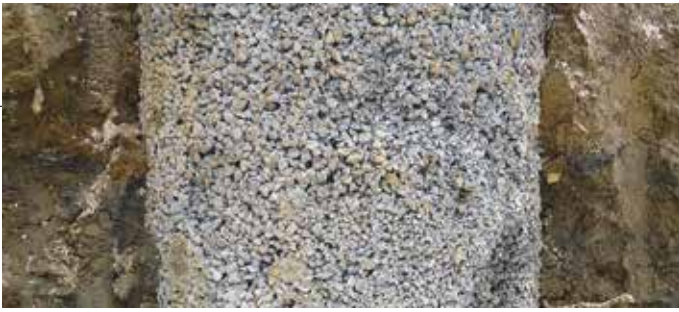
2. Un palo in calcestruzzo alveolare
